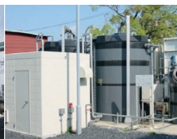
食堂及び鋳物油排水の処理
