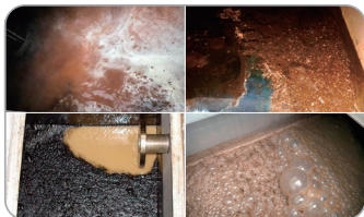
写真はスラッジ回収部です。
