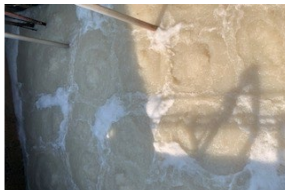
悪臭がなくなった調整層
